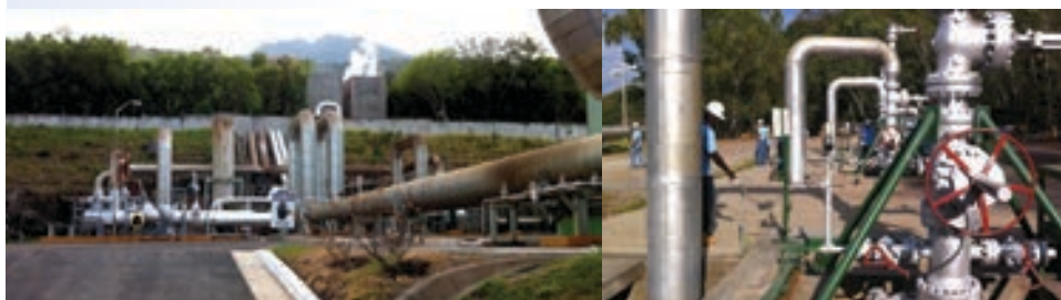
Figura 14 Líneas de conducción y cabezas de pozo en campo geotérmico de El Salvador 16
