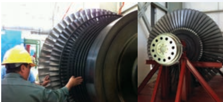
Figura 13 Turbina de vapor para geotermia en mantenimiento 15
